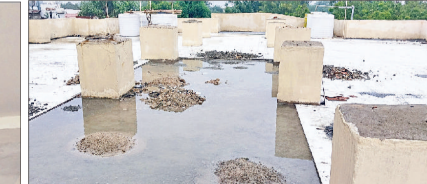
रेवाड़ी। गर्ल्स स्कूल के नए भवन का झड़ने लगा प्लास्टर व स्कूल के नए भवन की छत पर जमा पानी व हटाई गई टाइलें।
