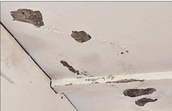
रेवाड़ी। गर्ल्स स्कूल के नए भवन का झड़ने लगा प्लास्टर व स्कूल के नए भवन की छत पर जमा पानी व हटाई गई टाइलें।
